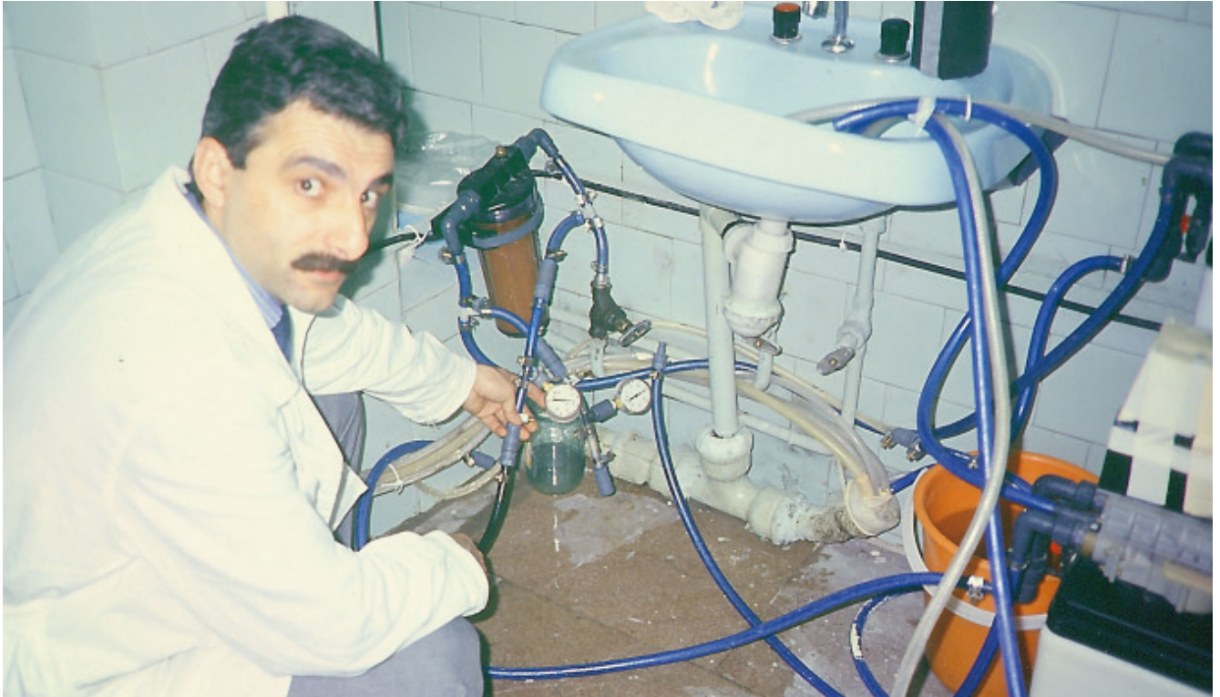
Abb. 2: Hayk bei der Installation der Dialysegeräte
